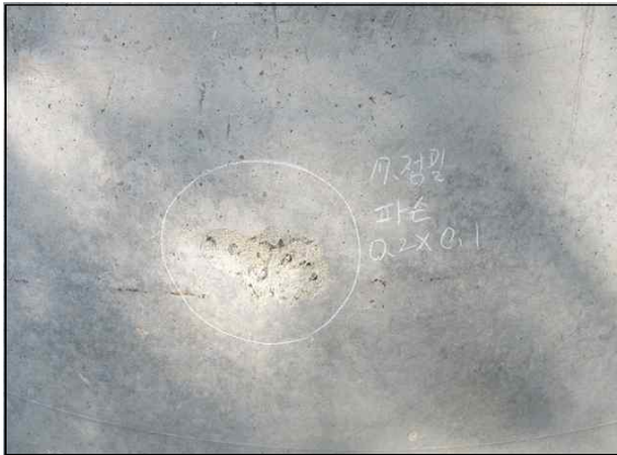
교각 기둥부 파손(P1)
