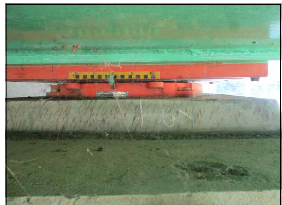
받침몰탈 균열(A2 SH3)
