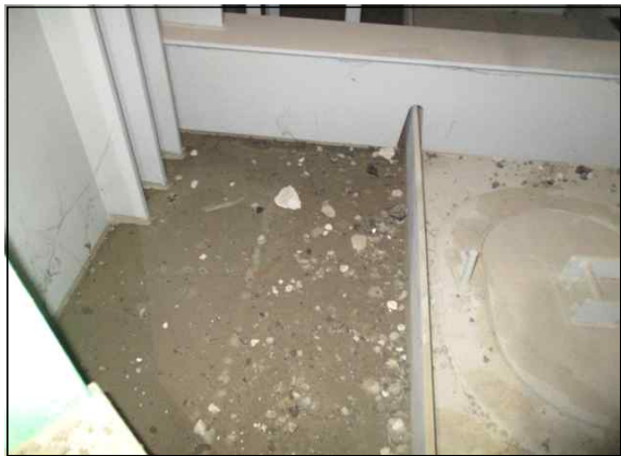
거더 내부 우수유입 흔적(S3 G2)
