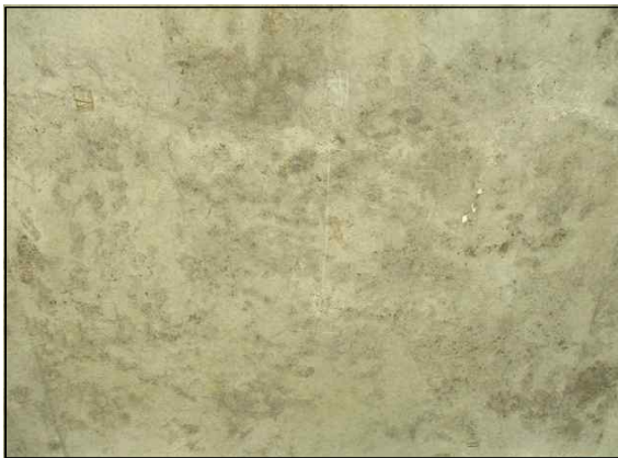
교각 기둥부 균열(P2)
