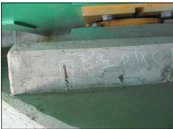
받침콘크리트 철근노출(A1 SH2)
