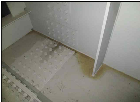
거더 내부 우수유입 흔적(S3 G1)
