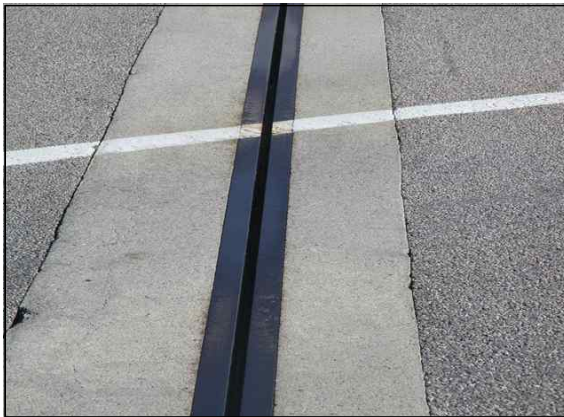
신축이음 후타재 균열(A1)
