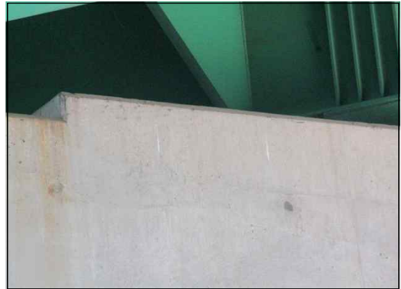
교각 코핑부 균열(P1)
